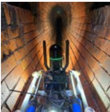
BILD: BLK Arc im Kanal auf Kanal-TV-Fahrgewagen
