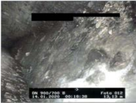
Bild: Verrohrter Bachlauf mit Geröll und Wasserstand
